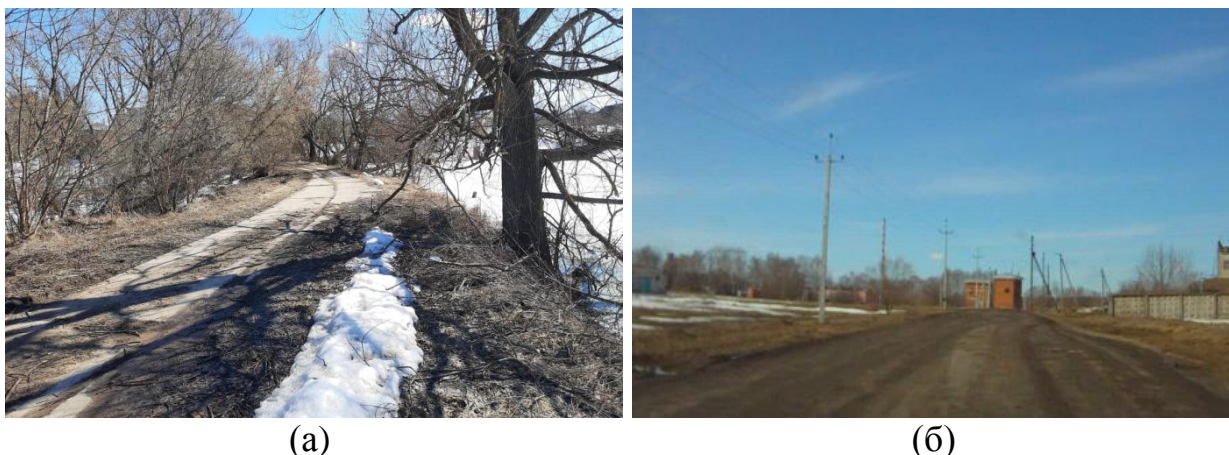
Рисунок 1.7 – АДОПММЗ в ненормативном состоянии: а – АДОПММЗ 46Н-02577 «"Зарайск - Серебряные Пруды" - Струпна»; б – АДОПММЗ 46Н-02554 «"Озеры - Кашира" - Трасна" - Октябрьское»
