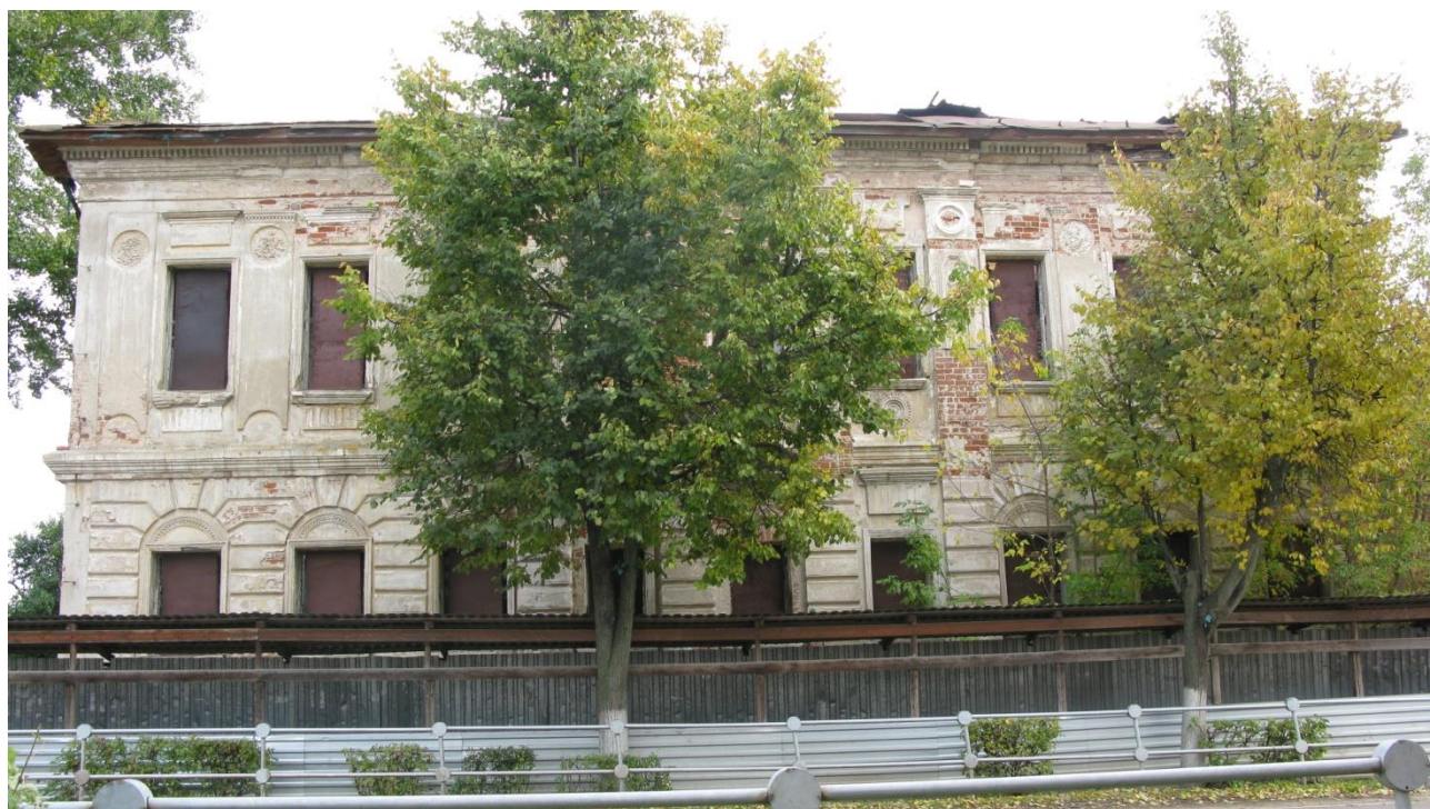
Дом Локтева, кон. XVIII - нач. XIX вв. Вид с юга, с ул. Ленинская.
